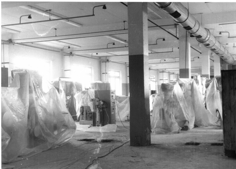
Новое оборудование подготовленное к монтажу в цехе оптических кабелей. Фотография 1989 г.
